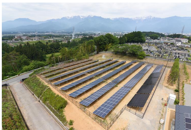
図表 58 リユース品を使用した発電所
