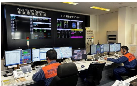
消防緊急通信指令施設更新事業
